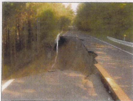
路肩決壊（高野龍神スカイライン）
