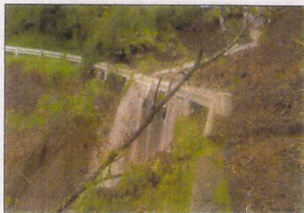
路肩決壊（林道弓手原線）
