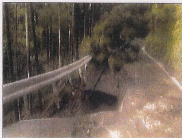
路肩決壊（県道高野天川線）
