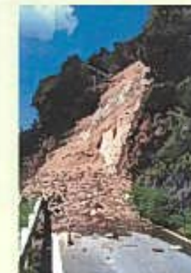
土砂崩落(竹園村道)
